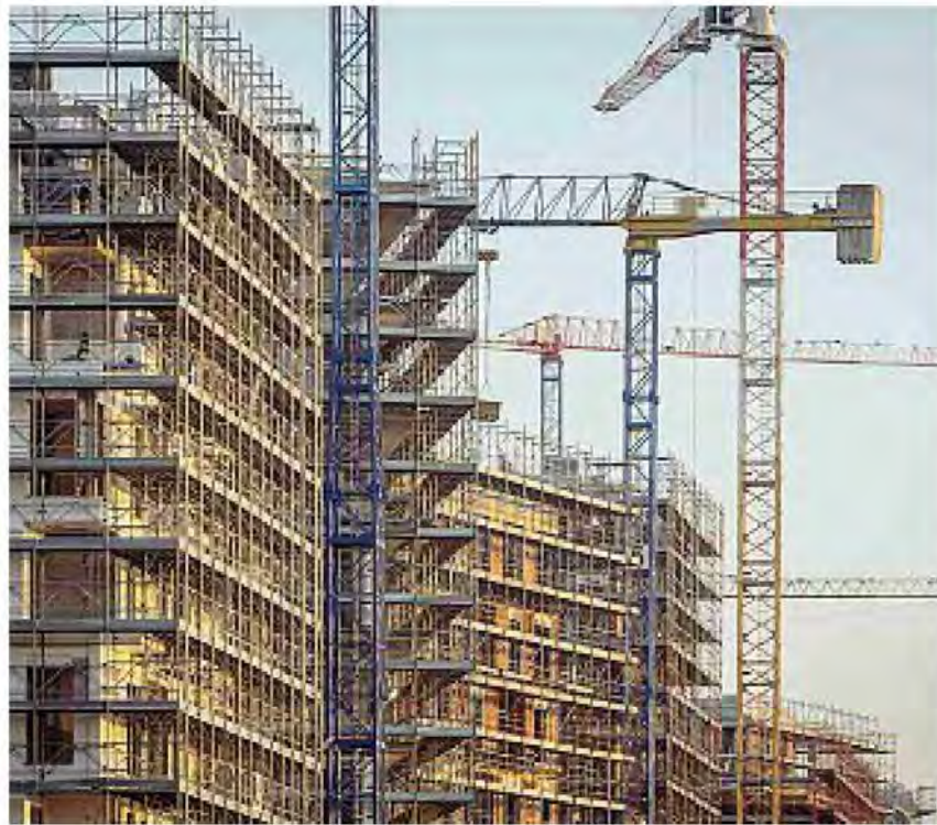
Trasformazioni Il cantiere del progetto Seimilano di Borio e Vårde nell'area ex Calchi Taeggi a Bisceglie
