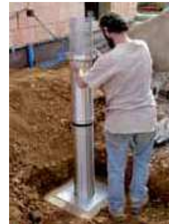
Presca d'aria nuova collegata al condotto geotermico
