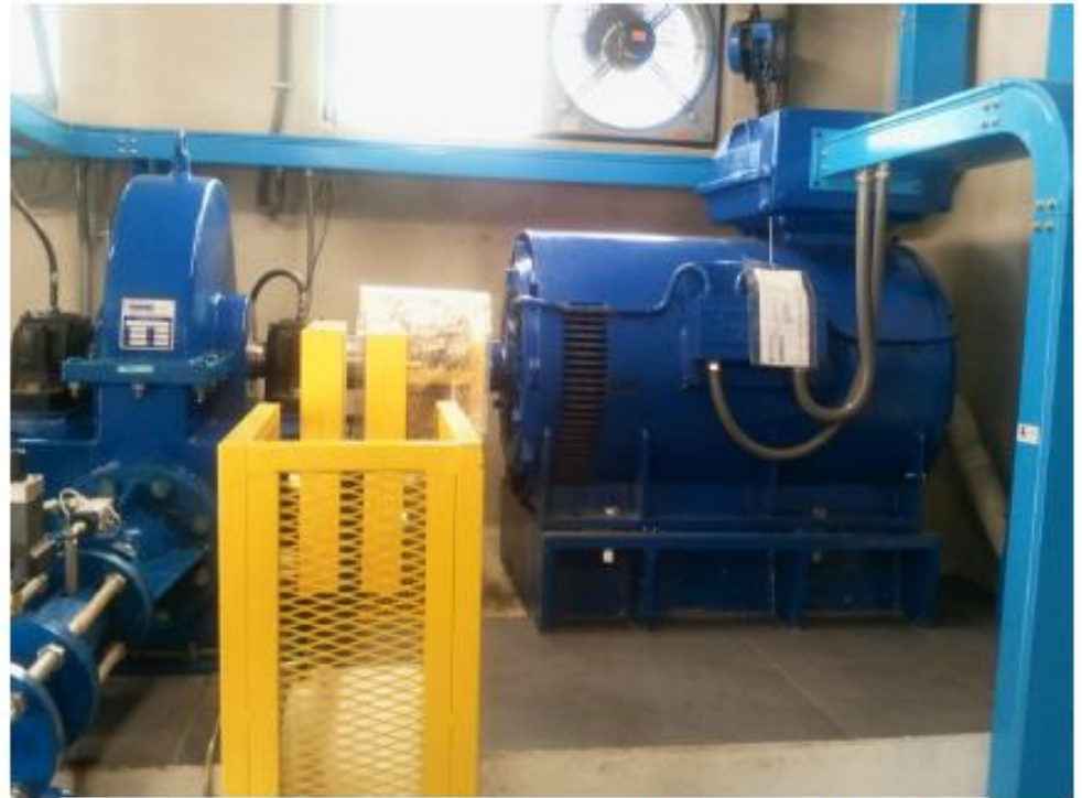
La centralina idroelettrica sull'acquedotto di Roncobello (BG)
